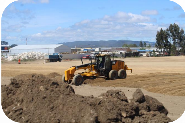
Relleno ilegal en Humedal Chimalfe.
