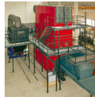
Caldera Pellets / Astillas, Biomasa para calefacción distrito, industria (20 MW)
