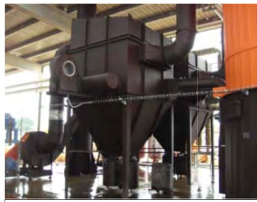
DEPURADOR DE HUMOS
